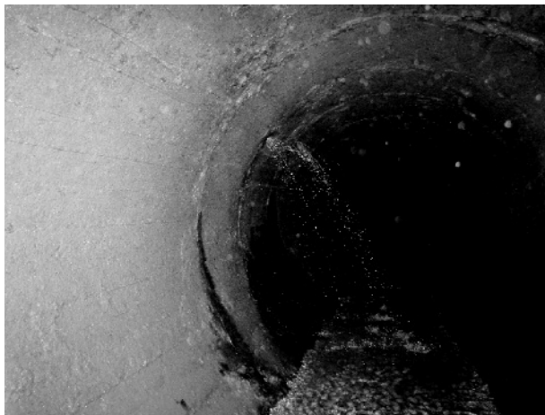
Рис.1 Напірні течі через отвори в обробці тунелю
