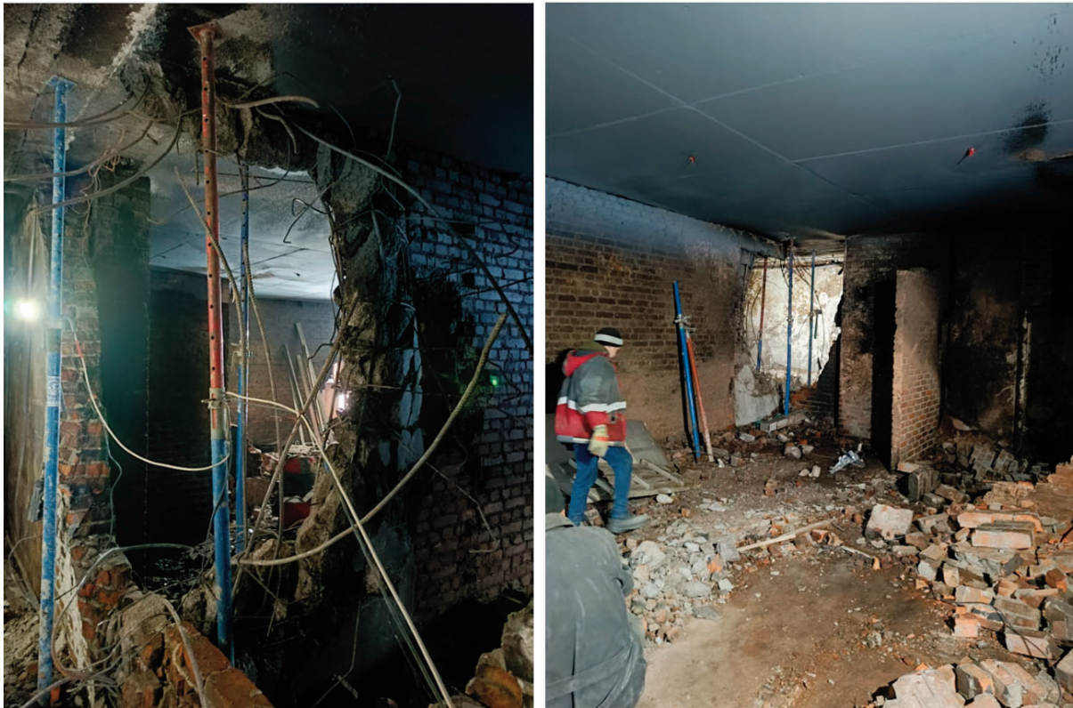
Рис. 2 Місце влучання всередині Блоку 2 на 22 поверсі
