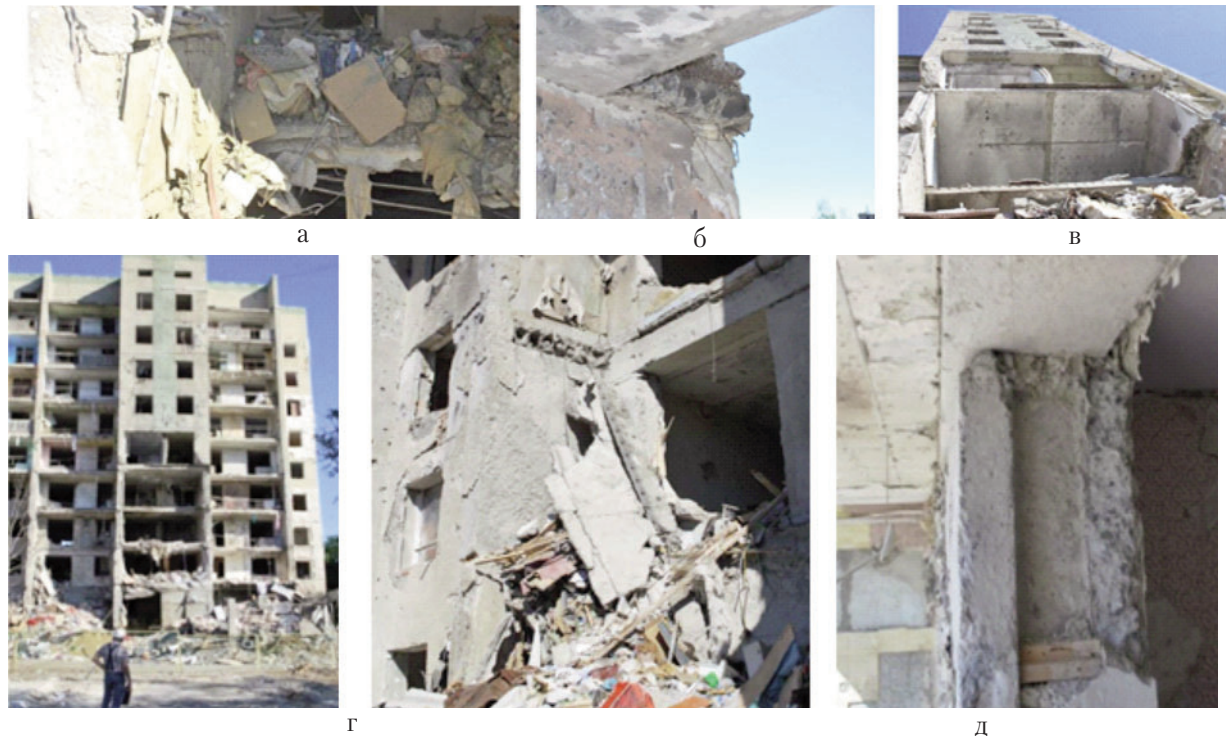
Рис. 1.7 Пошкоджена прямим влучанням ракети крупноблочна 9-ти поверхова житлова будівля в селищі Сергіївка (Одеська область, Білгород-Дністровський район): а) – обвалення плит перекриттів; б) – руйнування поясних стінових та підвіконних блоків; в) – зруйновані зовнішні стіни, заповнення прорізів; г) – руйнування балконних плит; д) – горизонтальне зміщення блоків
