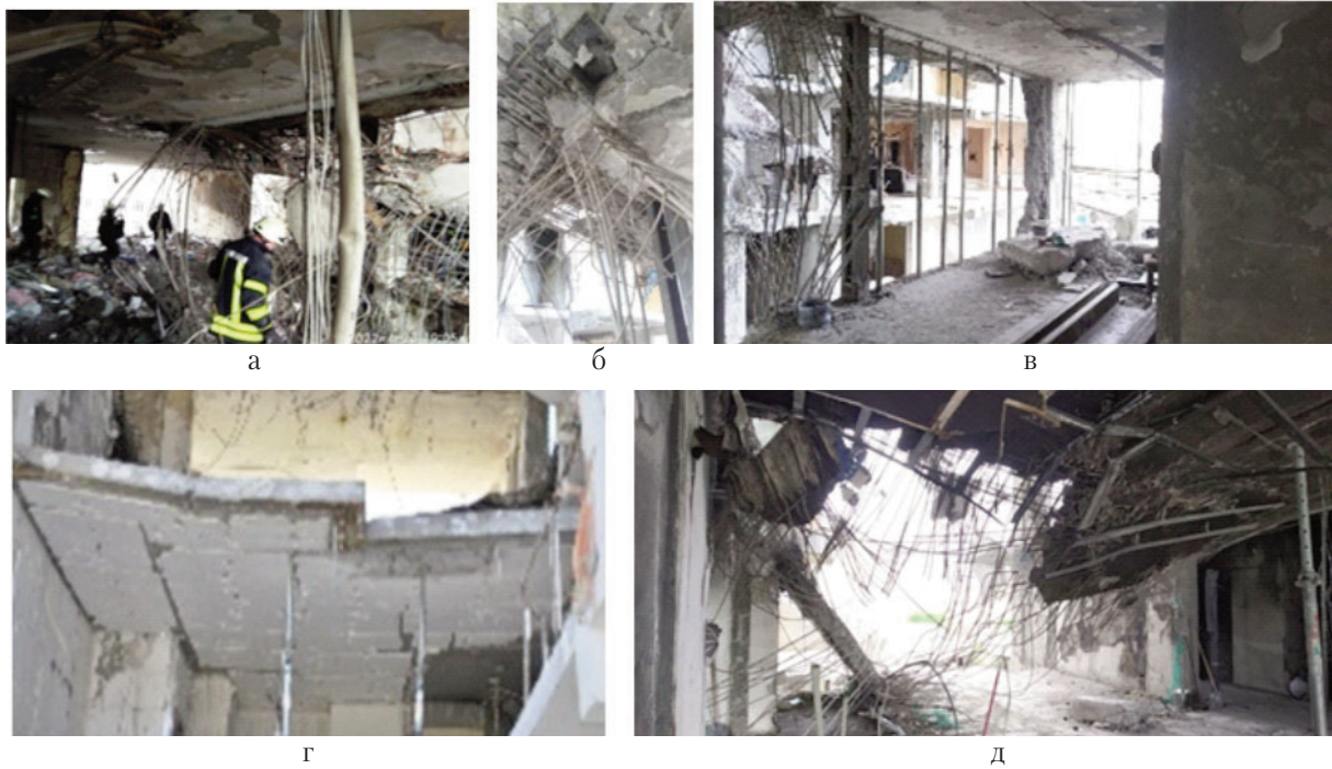
Рис. 1.6 Пошкоджена за другим випадком (прямим влучанням ракети) каркасно-монолітна будівля в м. Одеса – житловий комплекс «ТІРАС»: а) - повне руйнування частини діафрагми; б) – руйнування колони; в) – руйнування колон та пошкодження перекриттів (уламок діафрагми лежить на перекритті); г) – прогин перекриття, локально більший ніж 200 мм; д) – повне обвалення частини перекриття
