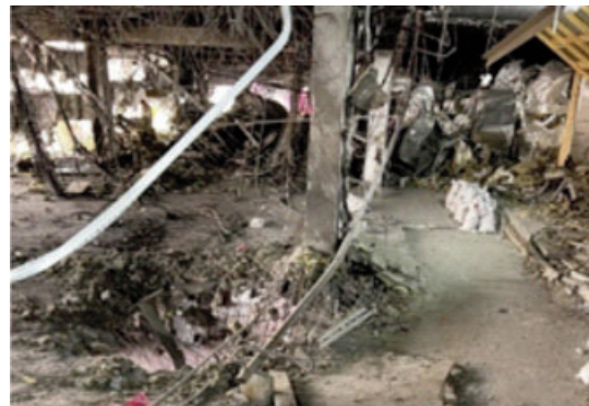
Рис. 2. Наскрізне руйнування залізобетонного перекриття 5-го поверху після повторних обстрілів 10.03.2022
