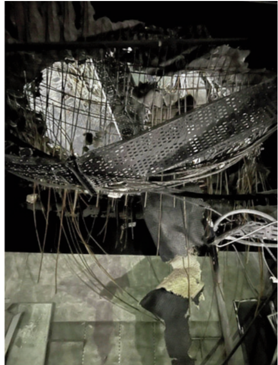
Рис. 4. Суцільне руйнування залізобетонних перекриттів
