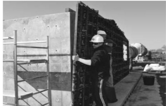
Рис. 4. Використання опалубки GeoPlast для укладання монолітного пінобетону при улаштуванні огорожувальних конструкцій житлової будівлі в м. Знам'янка
