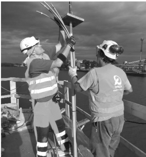
Рис. 4 Монтаж армованих арматурних елементів з високоміцних прутків СКТ \varnothing 28 мм S 670 Н, захисний рукав HDPE у вільній довжині та шланги високого тиску для хімічного анкерування. Загальна довжина анкерного елемента становила 13,7 м. Збірка проводилася на понтонах на стовпах, а кран був встановлений відразу після буріння свердловин. (Фото Minova Bohemia)
