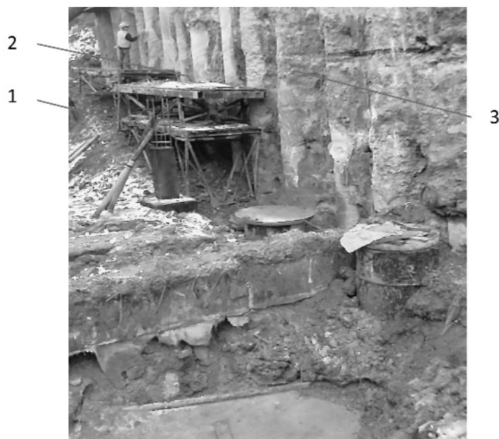
Рис. 8. Променеві дрени перед монтажем в палеву підпірну стіну ПС-10 1 — променева дрена в зборі; 2 — риштування; 3 — зовнішній ряд паль
