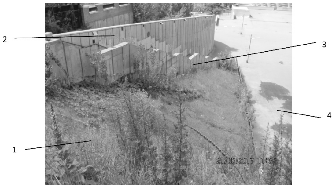
Рис. 2. Палеві підпірні стіни ПС-10 та ПС-11, що влштовані вздовж схилу 1 – крутий схил, 2 – палеві підпірні стіни ПС-10 та ПС-11, 3 – парапет з зовнішнього боку дробини, 4 – покриття майдану зони гостинності
