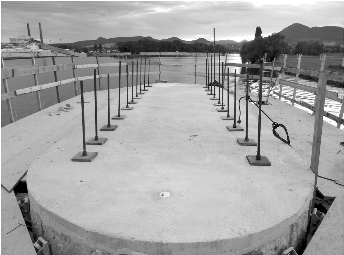
Рис. 6 Після завершення бурових і анкерних робіт на кожній опорі було встановлено 2х10 штук елементів арматури. Для монтажу нових шарнірів мосту застосовували армування та бетонування залізобетонних основ. (Фото Minova Bohemia)
