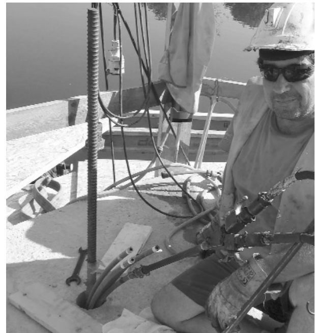
Рис. 5 Подання суміші за допомогою заливки шлангів високого тиску. Внаслідок цих умов застосовувалася двокомпонентна органічна мінеральна смола GEOFLEX. Він призначений для закріплення як в стандартних, так і в складних випадках – закріплених під водою, при несприятливих температурах, збільшені вимоги до навантаження і т.д. (Фото Minova Bohemia)
