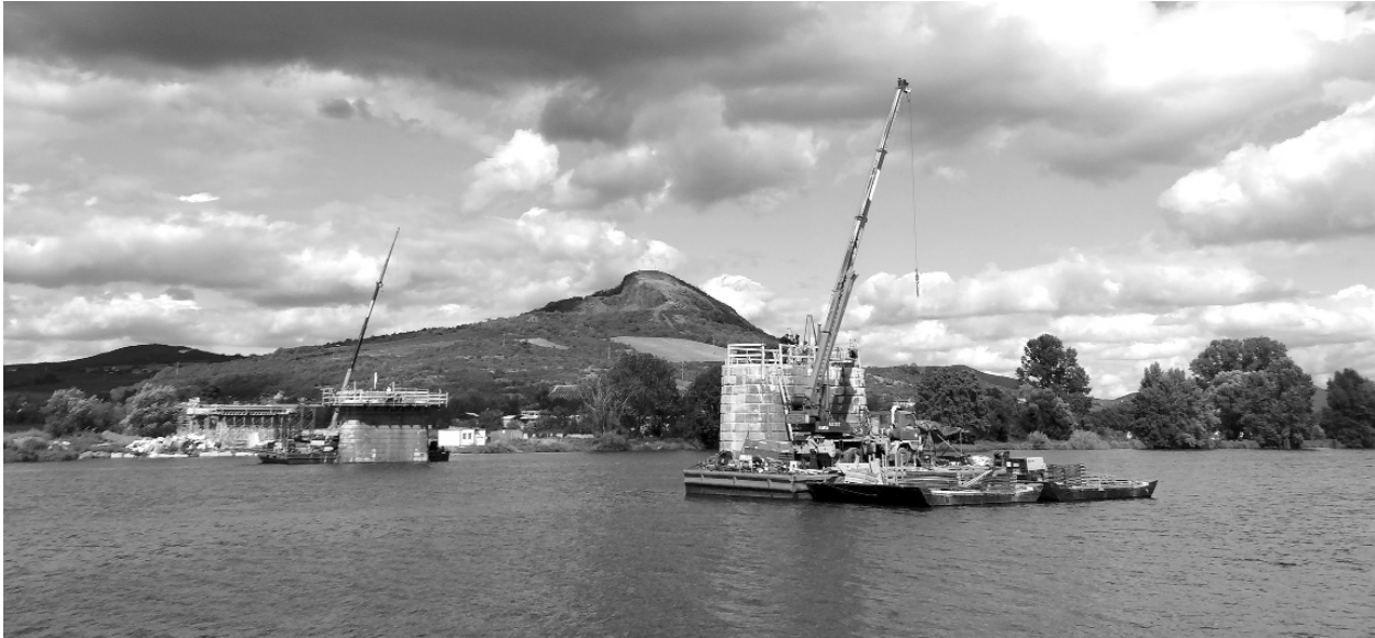
Рис. 1 Загальний вигляд стовпів Р3 і Р4 (далі) від лівого берега Ельби. Всі роботи, у поєднанні з попереднім натягуванням стовпів, проводилися з понтонів, прикріплених до стовпів. На тлі пагорба Radobyl, природного пам'ятника і чіткою домінантою Ловосице і Литомержице. (Foto Minova Bohemia)
