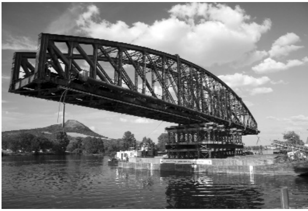
Рис. 2 Розбирання оригінальної і встановлення нових сталевих конструкцій в середній частині мосту через Ельбу здійснювалися в цілому за допомогою понтона.
