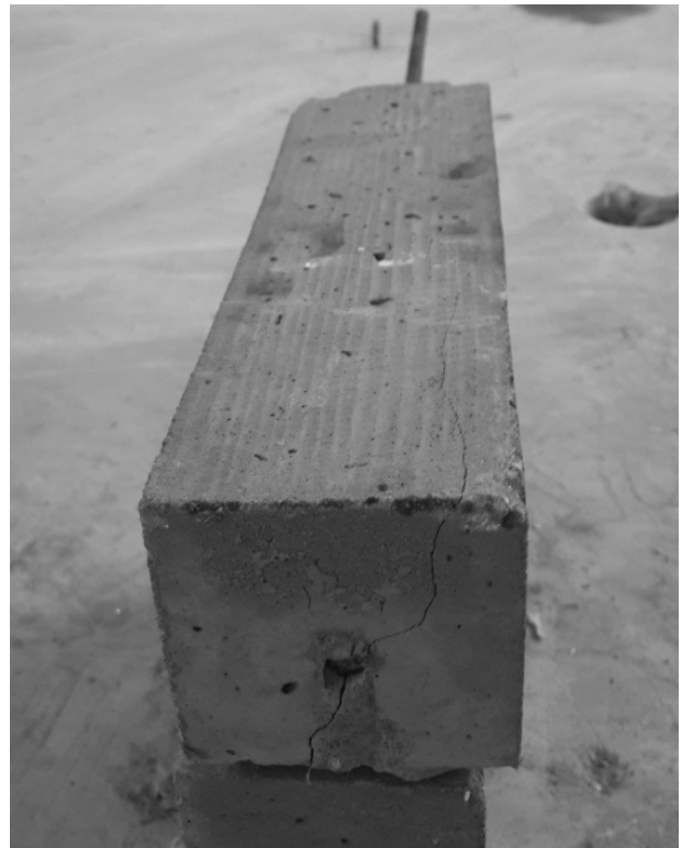
Фото 3. Дослідний зразок з гладкою арматурою після випробування
