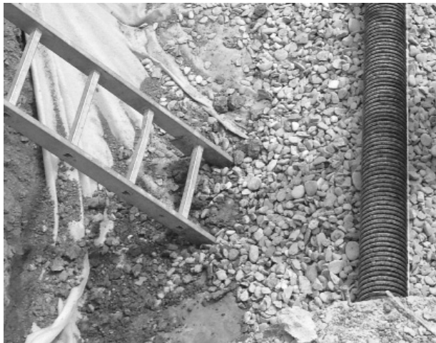
Рис. 1. Засорение грунтом фильтрующей обсыпки
