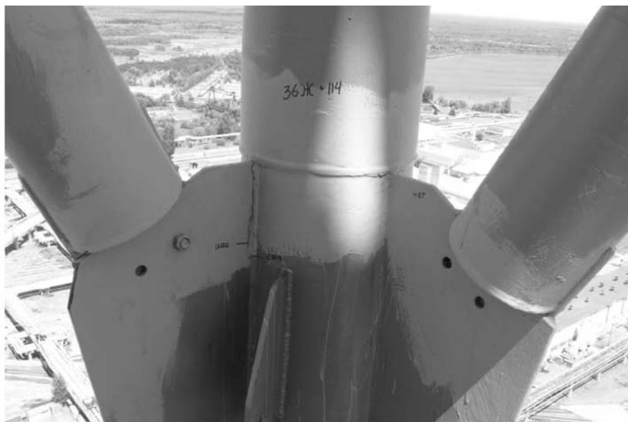
Рис. 1. Тріщини втоми в зоні сплавлення метала кутового зварного з'єднання
