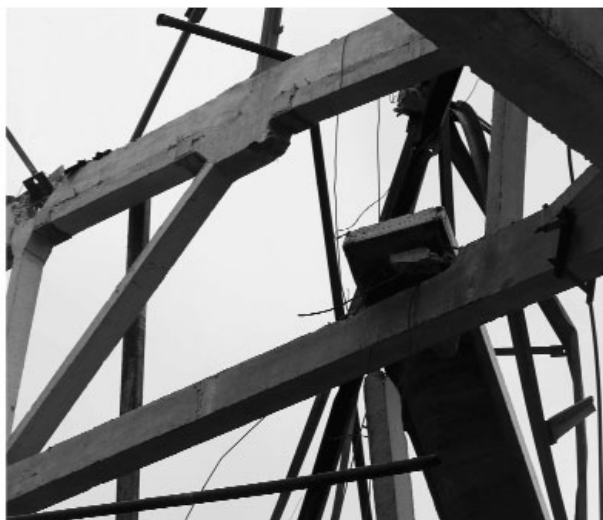
Рис. 1. Приклад пошкодження 24-метрової залізобетонної ферми, яка зазнала втрати елемента після обстрілу.
