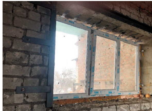
Рис 7. Розширення існуючих віконних прорізів з підсиленням зі встановленням металопластикових віконних блоків з потрійним склінням
