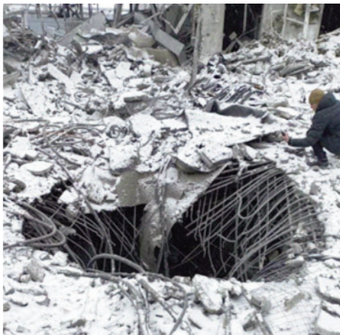
Рис. 5. Наскрізне руйнування суміщеної покрівлі, дахової котельні, устаткування
