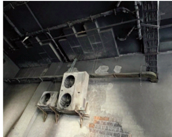
Рис. 6. Суцільне руйнування оздоблення та електротехнічних пристроїв господарської зони
