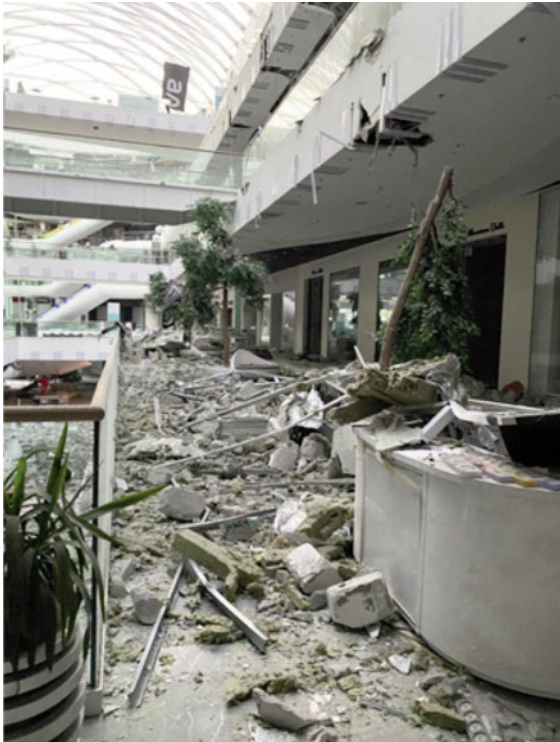
Рис. 3. Пошкодження оздоблення торговельного залу після перших вибухів 02.03.2022
