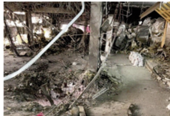
Рис. 2. Наскрізне руйнування залізобетонного перекриття 5-го поверху після повторних обстрілів 10.03.2022
