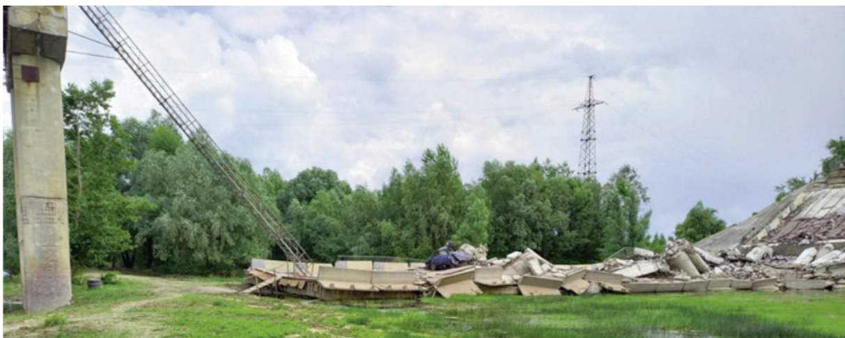
Рис. 2. Зруйновані прогони між опорами 7÷11
