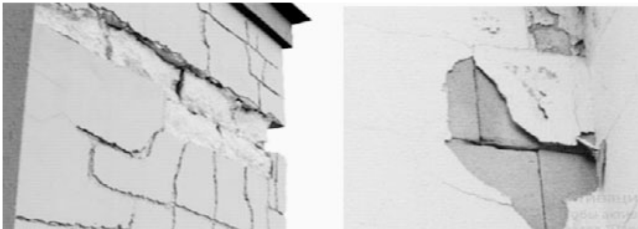
Рис. 1. Фрагменти стінових огорожувальних конструкцій з різними видами руйнувань, виконаних з газобетону білоруського виробництва у Білорусі.
