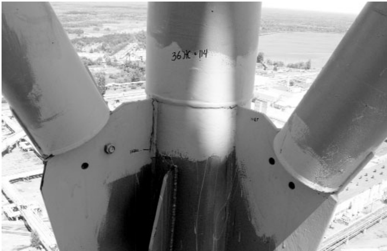
Рис.1. Тріщина втоми в зварному з'єднанні елементів каркасу існуючої витяжної труби.
